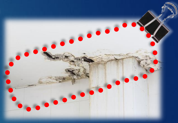
外壁クラックから漏水
