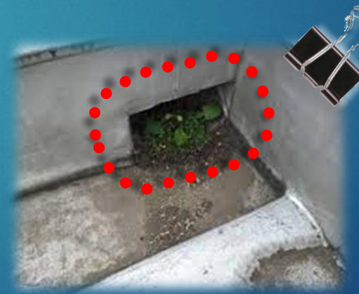
排水口の詰まり
