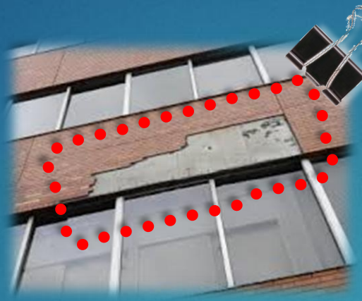
外壁タイルの落下
