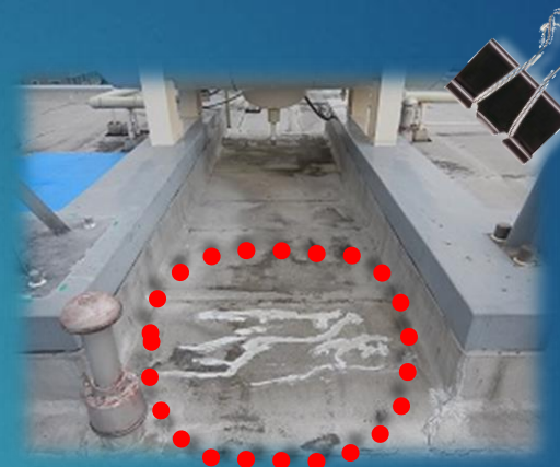
屋上からの漏水
