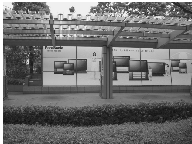
屋根の隙間から雨
