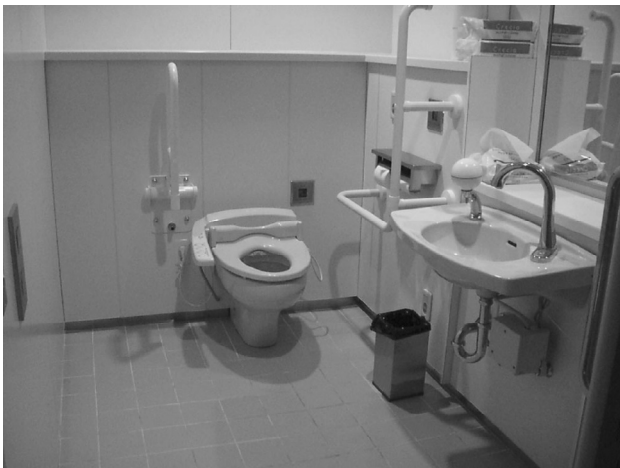
多目的トイレ内に着替えるための台を設置していない
