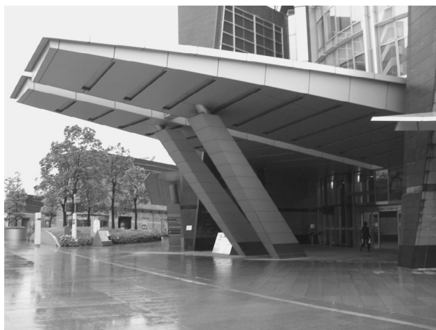
出入口付近に雨の吹込みがある
