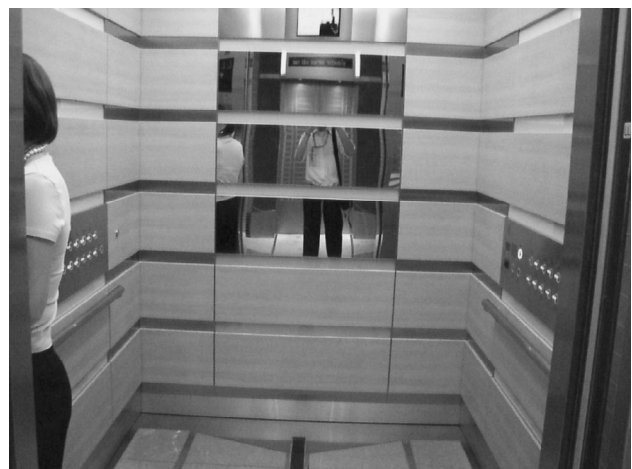
障がい者用エレベータにおける手すりが正面の壁に設置されていない
