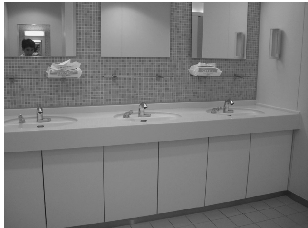
洗面台が高く、かつ車椅子でひざが入るスペースがないため、車椅子使用者が使いにくい。
