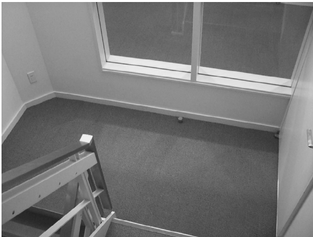
車椅子使用者等が避難時に待機するスペースがない
