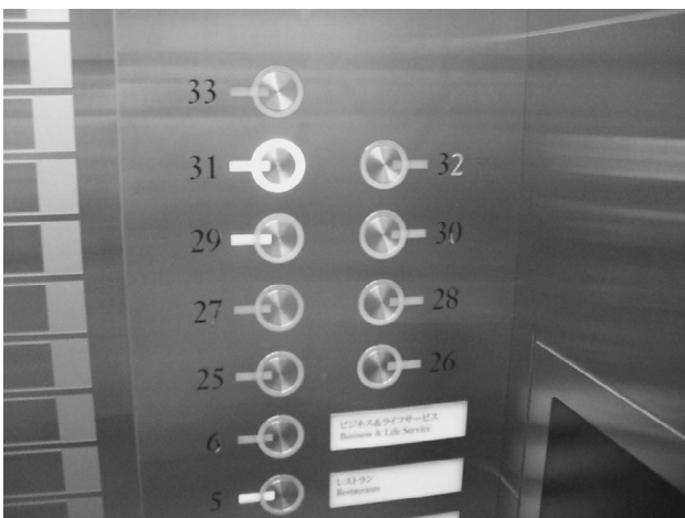
操作ボタンに階数が浮き彫り表示されていない
