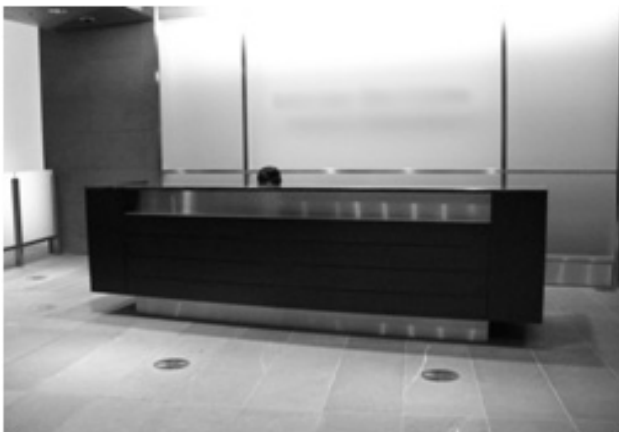
受付カウンターに、来訪者が手荷物を置く棚がない。 また、車椅子使用者用カウンターが未設置。
