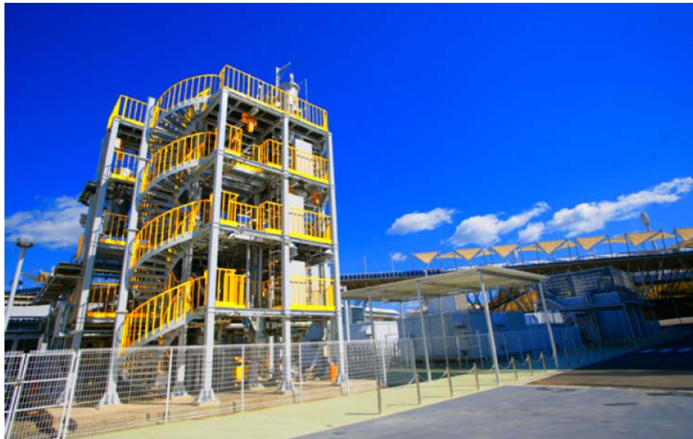
高温ガス化システム
